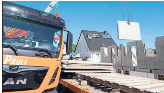
Im firmeneigenen Lkw angeliefert schwebt hier ein Doppelwand-Element auf die Baustelle. Mit den Fertigdecken, die täglich bei Pauli gefertigt werden, kann man bis zu 15 Einfamilienhäuser bauen. Foto: ProjectPartner Dirk Kleeschulte
